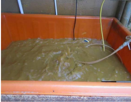
图 3.4 废水处理设施
